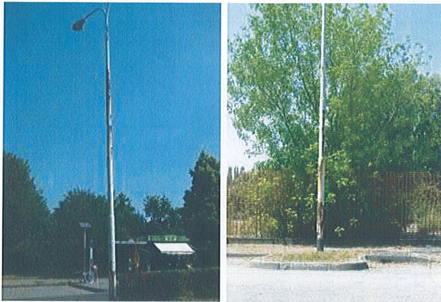
Sostegni con evidenti segni di ruggine in Via Primo Maggio (sx) – Via Liguria (dx)
