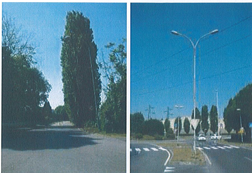
Sostegno fuori piombo in Via delle Rimembranze (sx) – Sostegni con ruggine Via Primo Maggio (dx)
